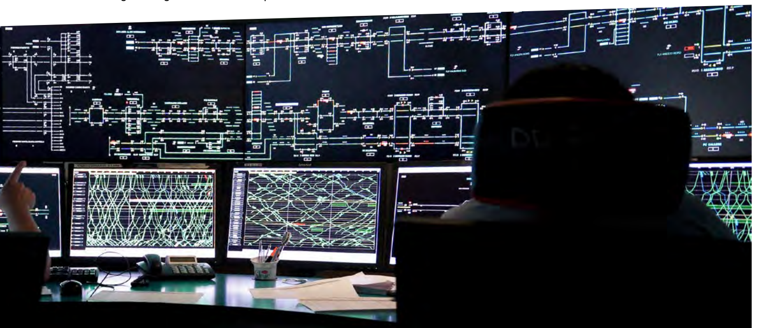
Tecnologia ERTMS, Sala Operativa RFI
